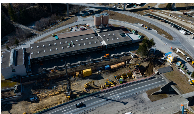
Accanto all'ingresso della galleria si sta costruendo il bacino di accumulo per il trattamento delle acque luride provenienti dallo scavo.
