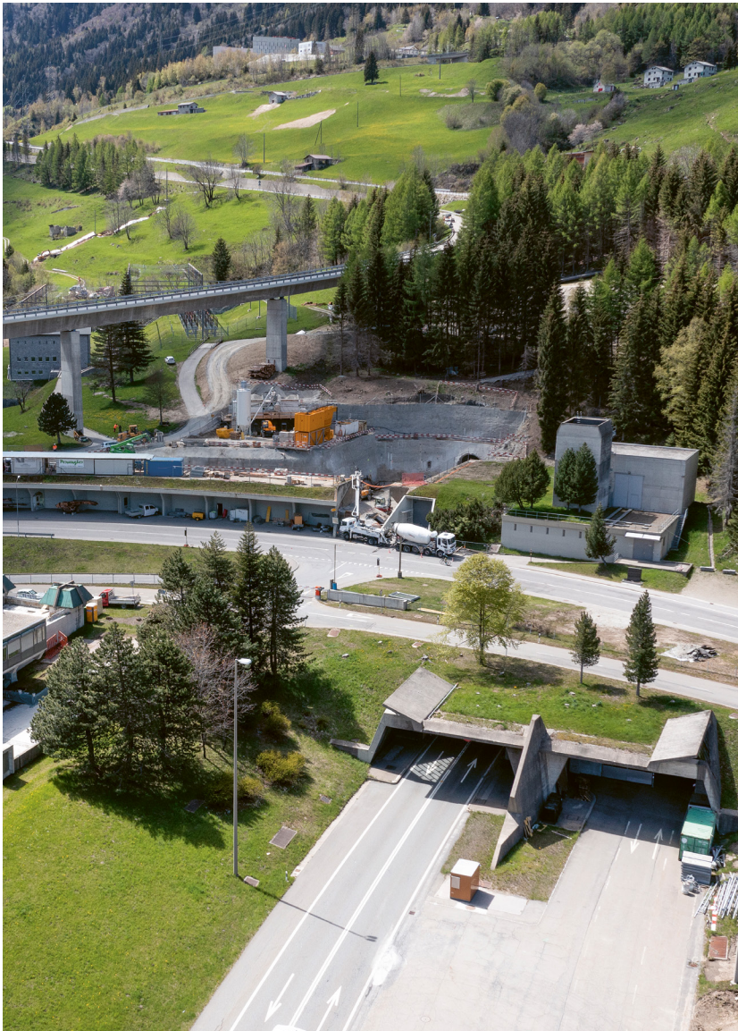
La nuova entrata del S1Sto viene realizzata a monte della Via della Stazione, a ovest della centrale di ventilazione.
